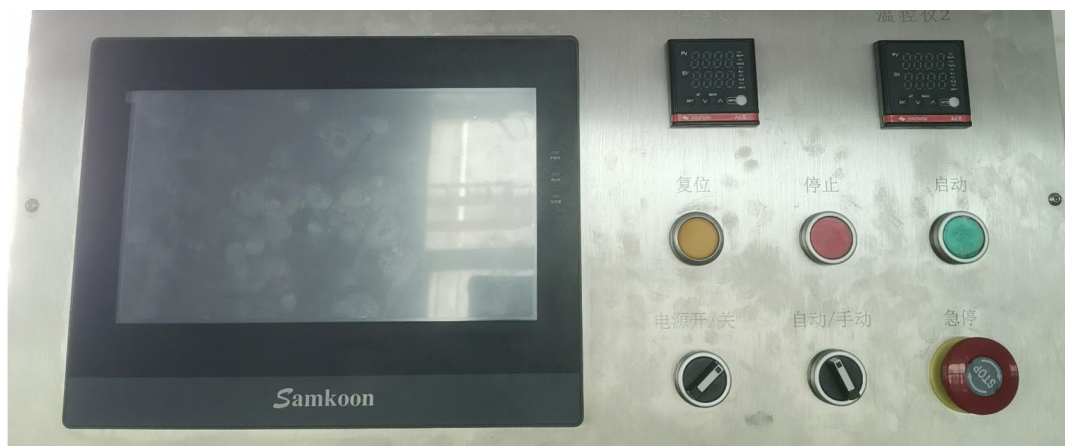
Panel de control con PLC Mitsubishi
